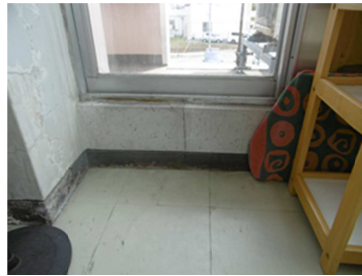
窓廻りの老朽化と 窓下のひび割れ
