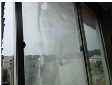
割れている窓
