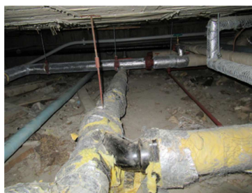
設備配管劣化状況
